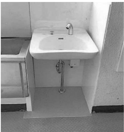
車椅子でも使用可能な洗面台
