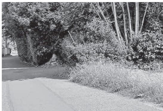
町道にはみ出した枝木
