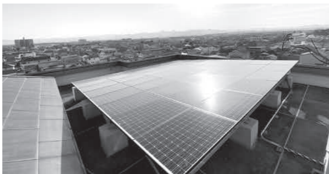
役場屋上に設置された太陽光パネル
