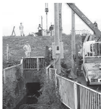
矢川樋管の排水訓練
