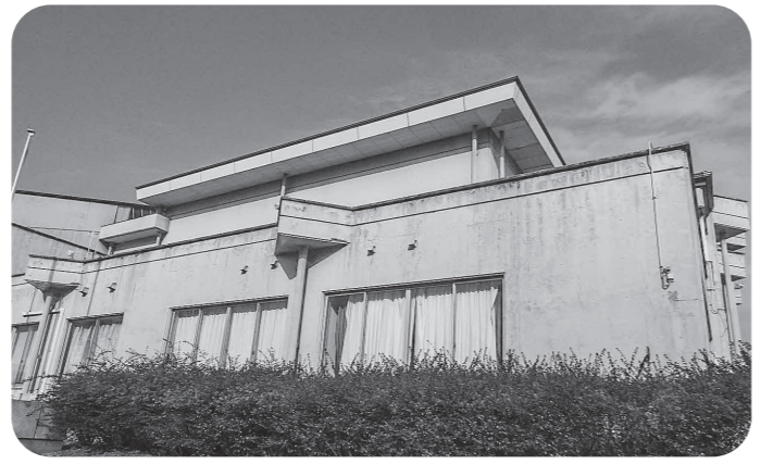
傷みが激しい社会体育館の外壁
