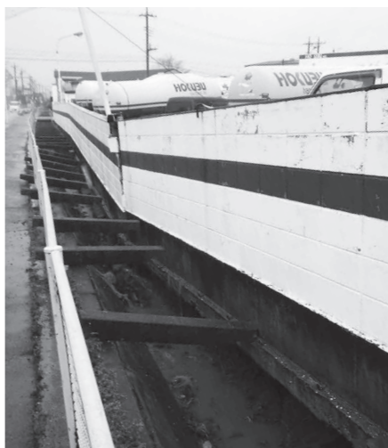
被害を受けた農業用水路
