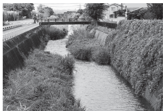
堆積土に樹木・雑草が繁茂し流れを阻害している
