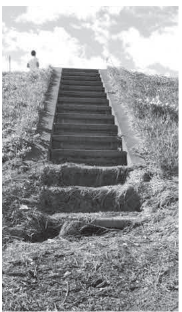
矢川樋管の内水氾濫箇所
