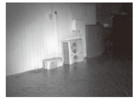
水に浸かってしまった室外機(五料)
