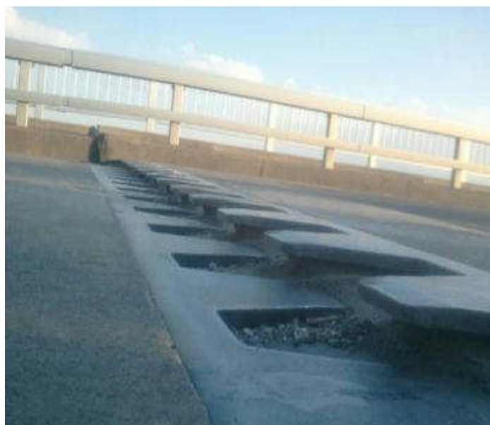
東北地方太平洋沖地震により被災した五料橋
