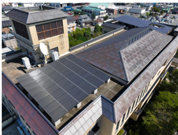
太陽光発電システム（庁舎屋上）
