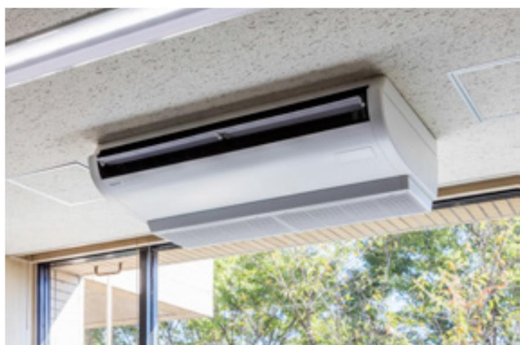
庁舎内空調設備
