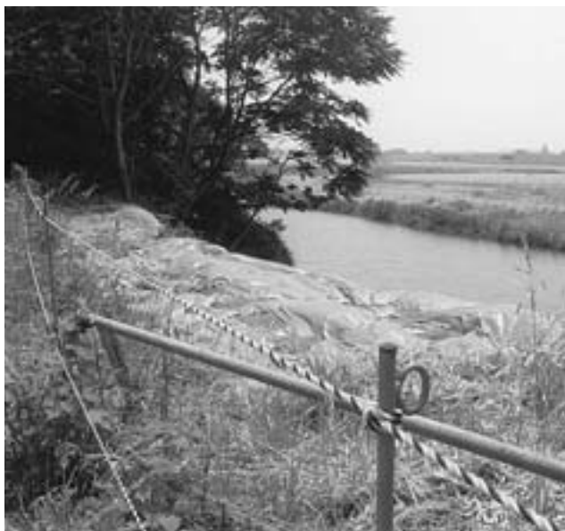
烏川左岸の崩落場所
