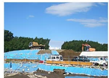
(仮称) 利根川新橋の整備 東毛広域幹線道路 (国道 354 号バイパス)
