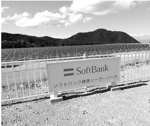
敷地面積4万9000㎡のメガソーラー発電所
